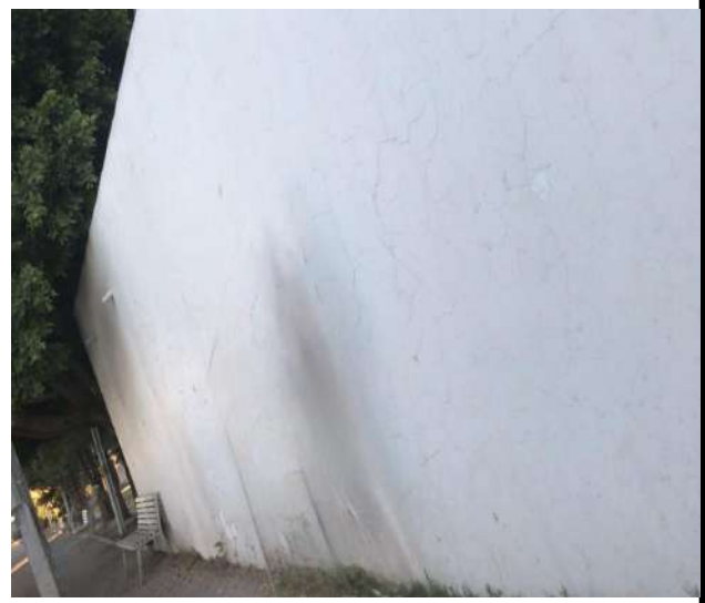
Noviembre/2024, Identificación de muro amplio en deterioro, sin función visual positiva, en calle J. J. de los Ramos esquina con calle Camelinas sin número, colonia San Isidro,
