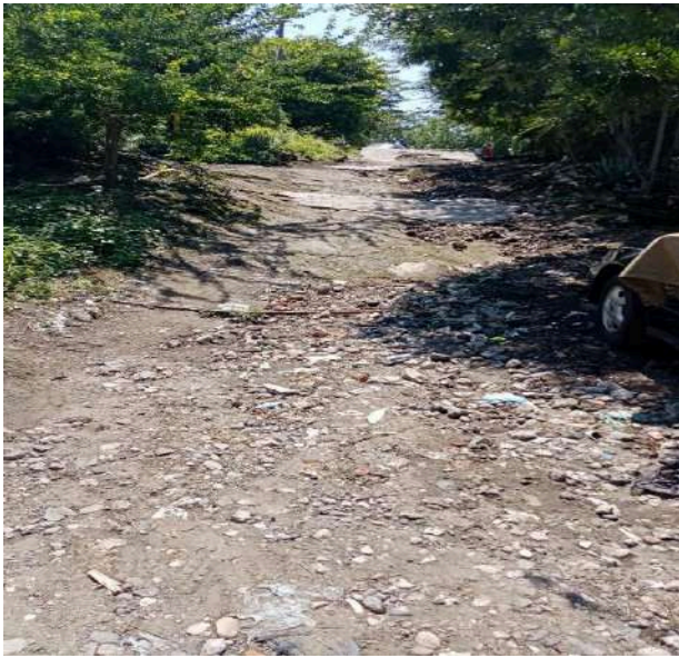
Esta calle se encuentra en condiciones deplorables por lo que se requiere de su reparación.
